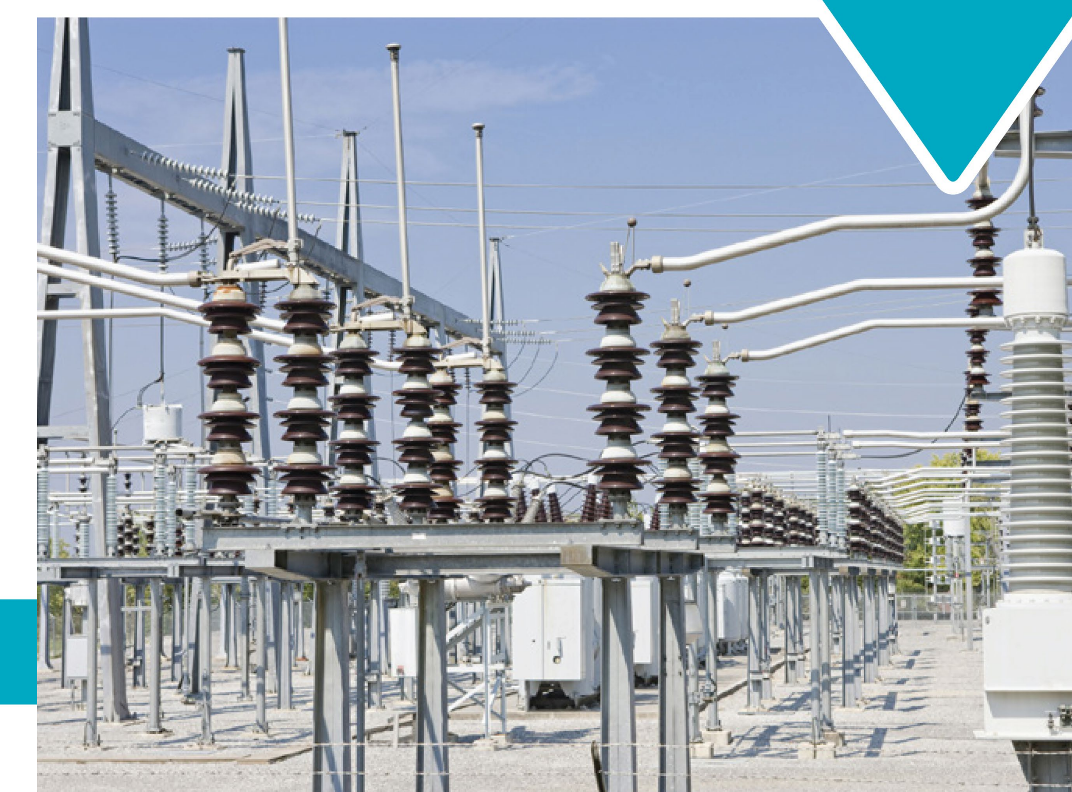
Distribution Substation Subestación de distribución
