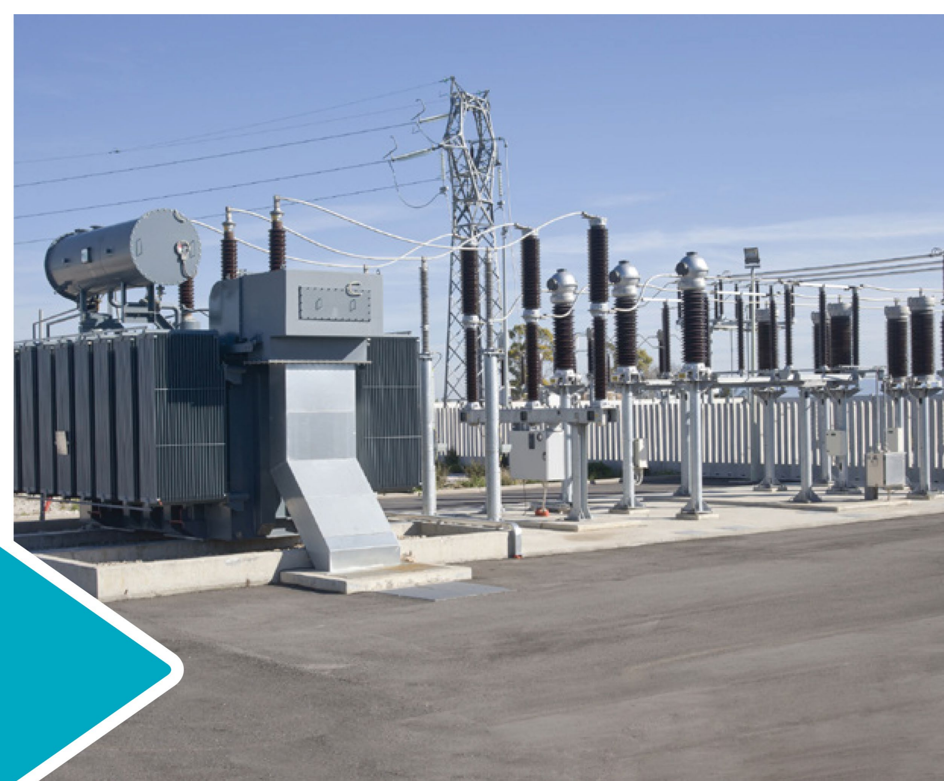
Transmission Substation Subestación de transmisión
