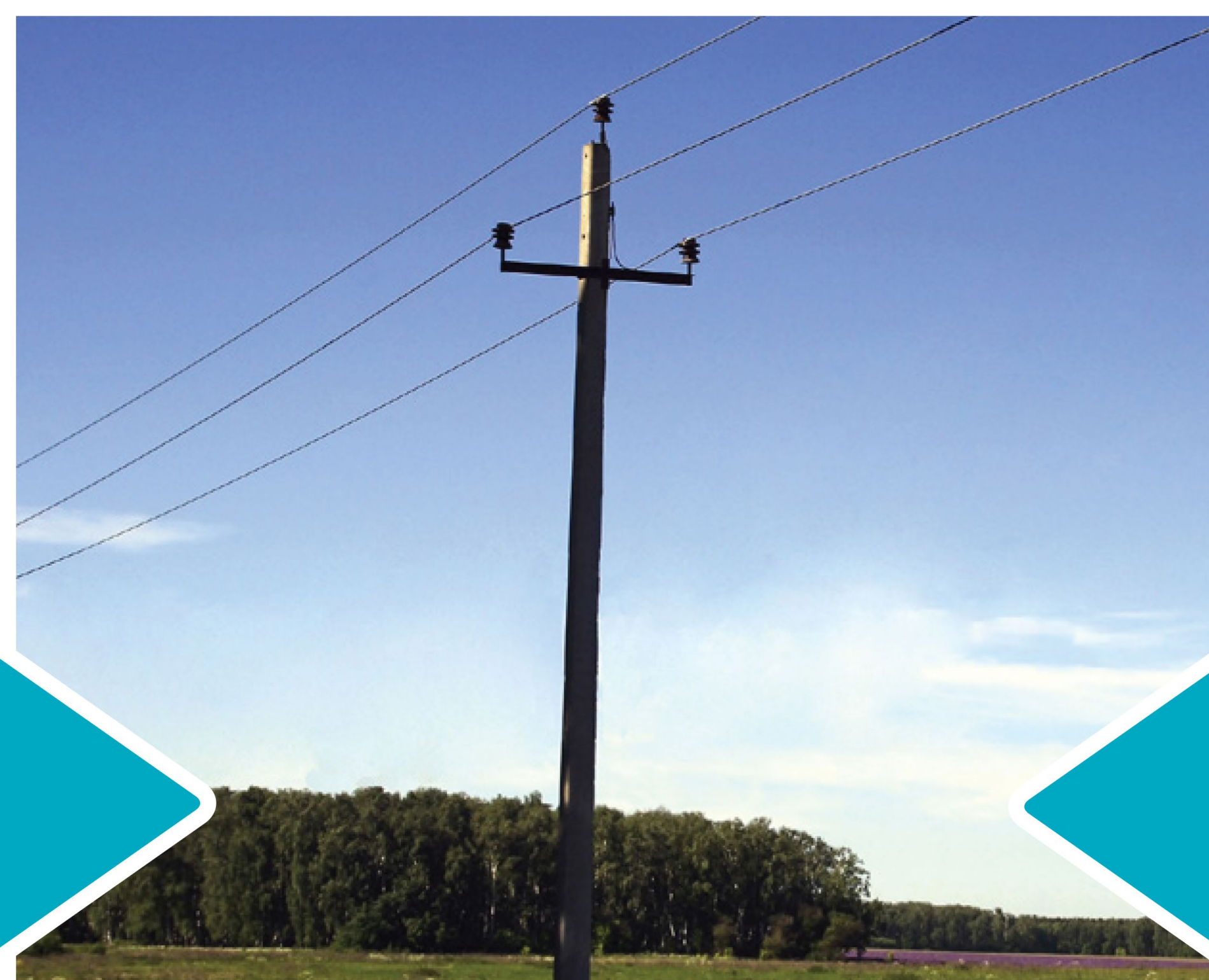
Distribution Lines Líneas de distribución
