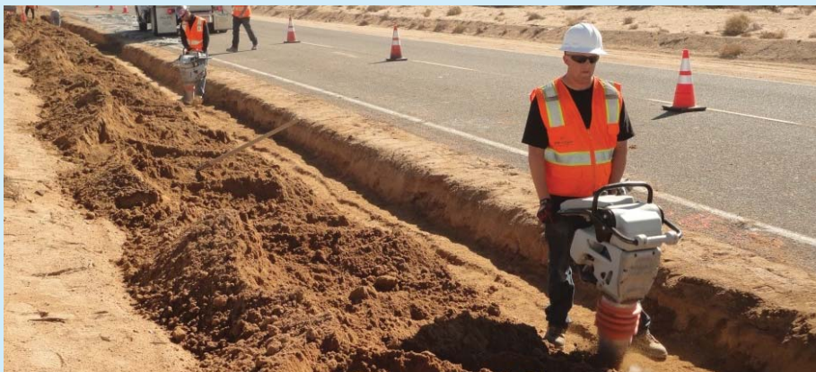
El personal de PG&E instalando la nueva tubería para suministrar agua dulce a la escuela de Hinkley.
