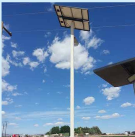
El panel solar financiado por PG&E, similar al que se muestra en la foto, ayuda a preservar los escasos árboles de Hinkley.
