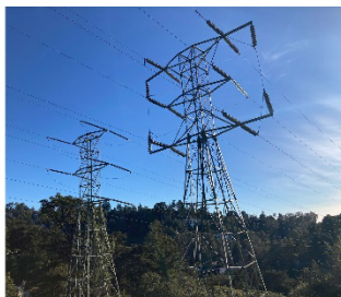
Lattice tower Torre de celosía
