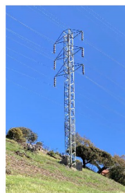
Lattice pole Poste de celosía
